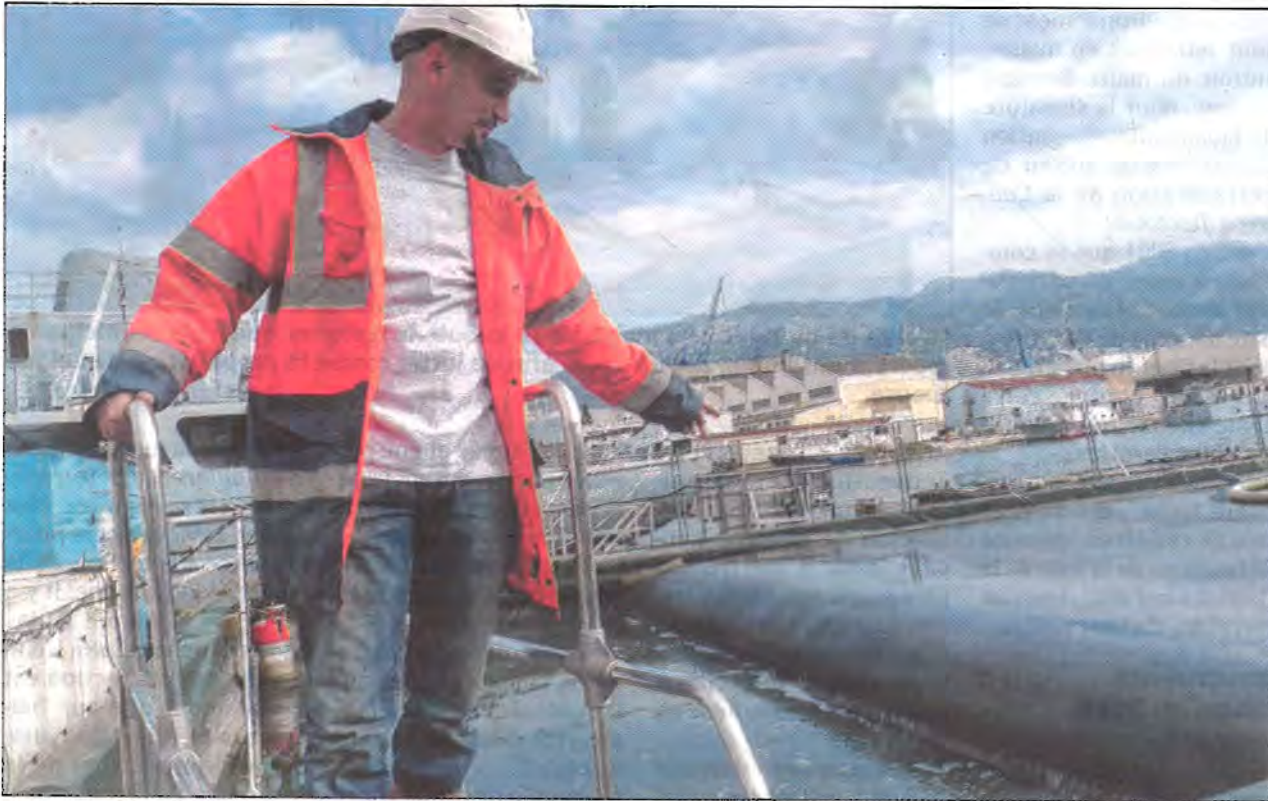
Commencée en mars dernier, l'opération de dépollution pyrotechnique devant le quai Noël n'est toujours pas achevée.
