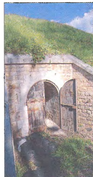
Une porte rouillée, habituellement condamnée
