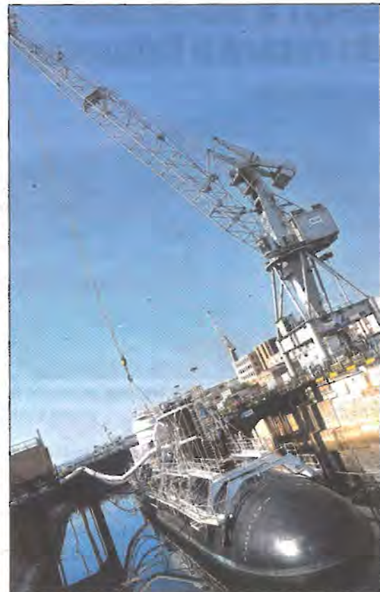
Pour accueillir à quai les Barracuda , comme c'est le cas aujourd'hui pour les Rubis , de nombreux travaux seront nécessaires dans la base (Photo F. G.)
