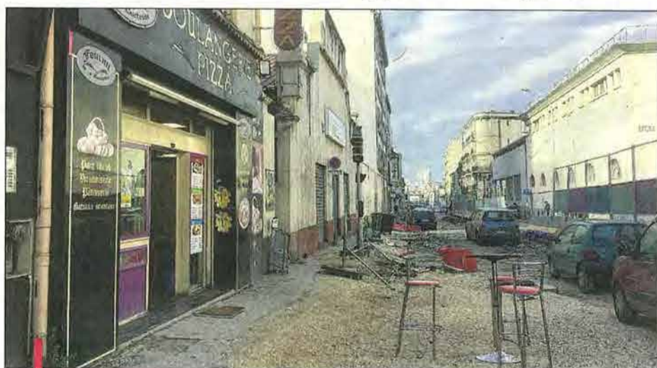
Les travaux commencés en juin sur l'avenue Roger-Salengro entre le boulevard Mirabeau et la rue de Chanterac (3 e ) ne reprendront qu'en janvier pour une livraison fin avril. /PHOTO L.M.
