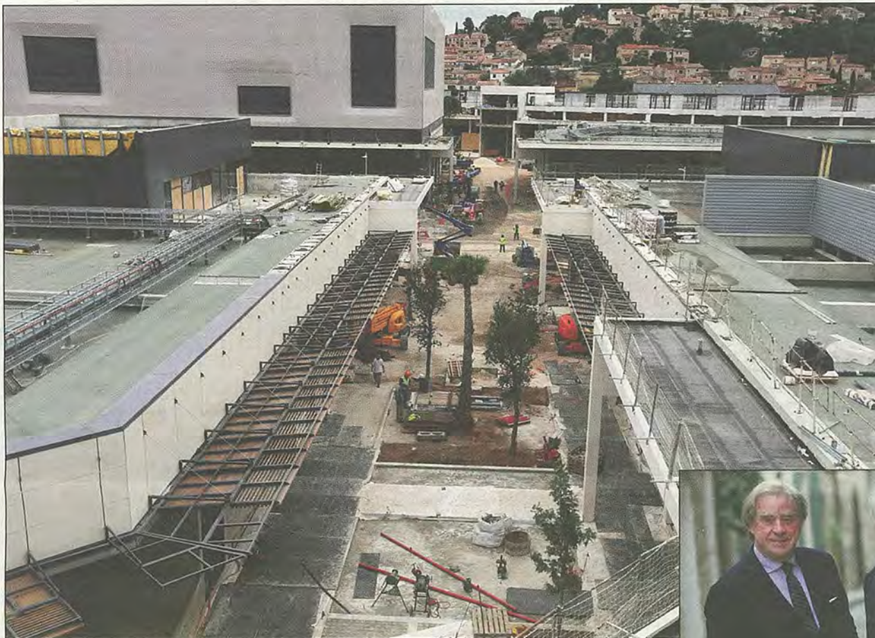
Le mail commercial à ciel ouvert (50 boutiques et les 16 salles du complexe cinématographique, ouvert au public le 13 avril) est traversé par une allée piétonne « végétalisée », selon Jean-Michel Wilmotte. (Photo Patrick Blanchard)
